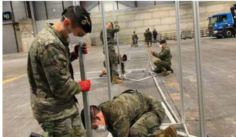
Montaje de la infraestructura de paneles para compartimentar el pabellón de IFEMA
