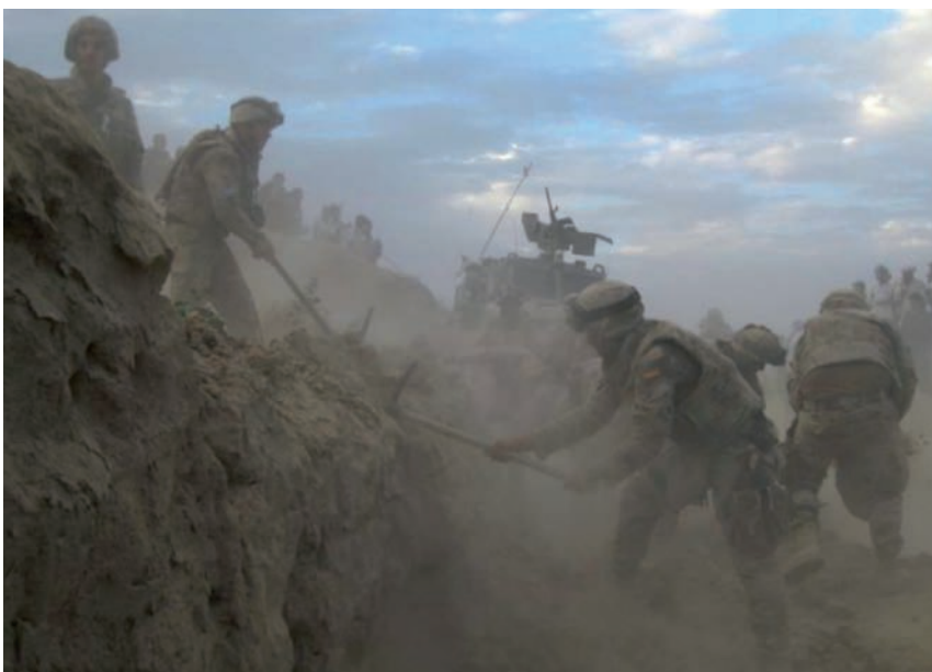
Otro momento del trabajo de los zapadores en la construcción de la COP de Ludina
